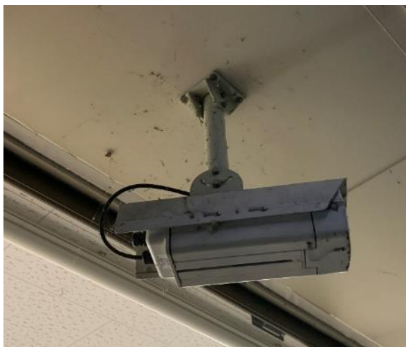
カメラ (取付前)
